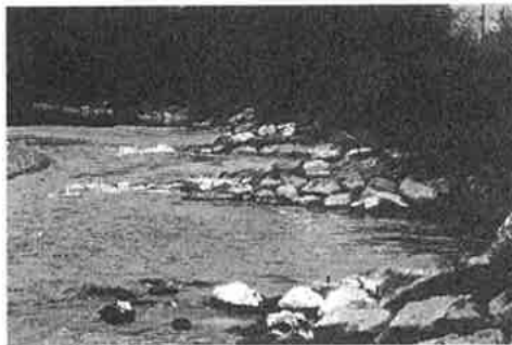
二次改修によって作られた、水衝部の上向不透過型石積み水制
