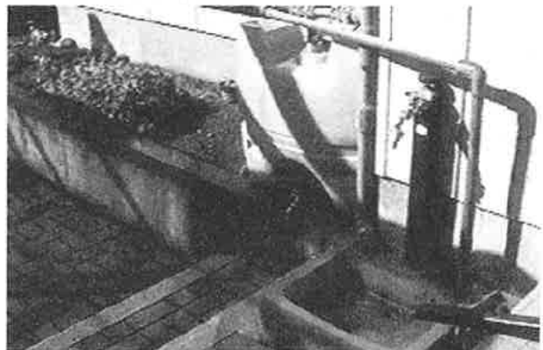
雨水タンク2:雨樋から雨水を貯める250リットルのタンク
