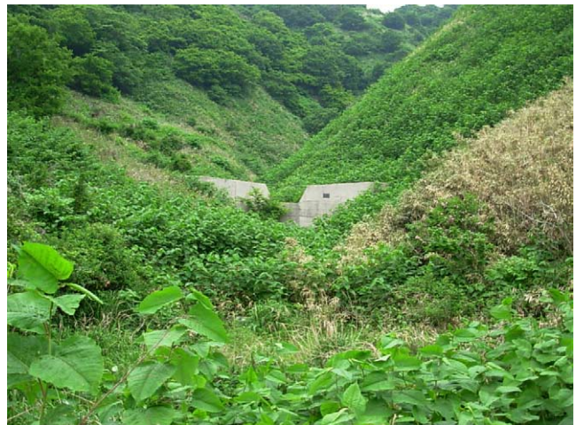
写真二 堰堤の上下流部とも草木が繁茂
