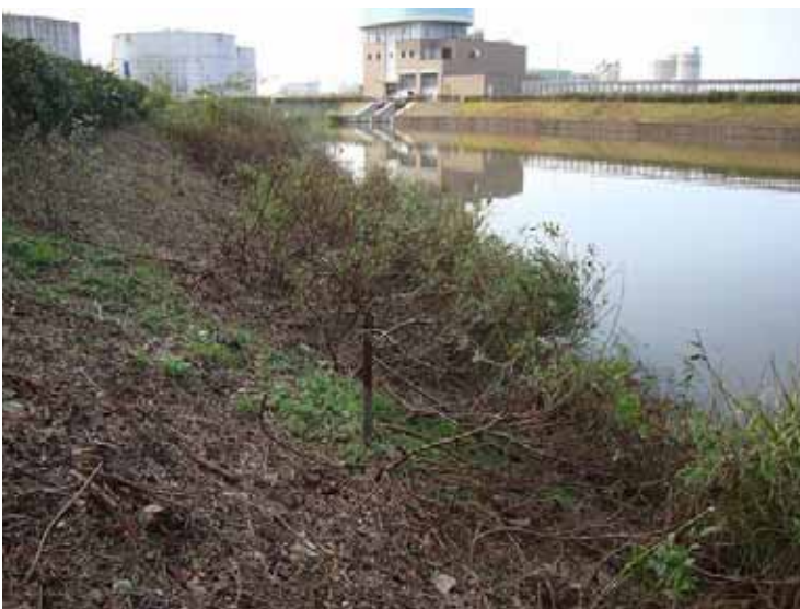
川側斜面伐採完了。 水際は猫柳、パイプ杭はリンコーの残置杭。
