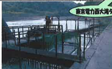
西大滝ダム魚道に設置の捕獲用トラップ
