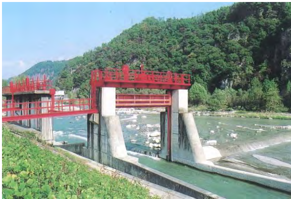
写真1・徳島堰頭首工 (大熊撮影) (固定堰と土砂吐水門、一番手前に魚道がある。)
